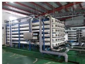
海水淡水化設備
